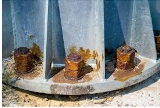
Şəkil 2. Galvanik Koroziya
