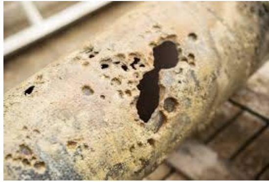
Şəkil 3. Pitting (Nöqtəvari) Koroziya
