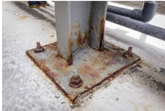
Şəkil 4. Yarıq Koroziya
